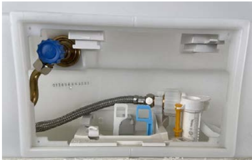
Zustand Spülkasten mit demontierter Revisionschutzplatte und Elektronik.
